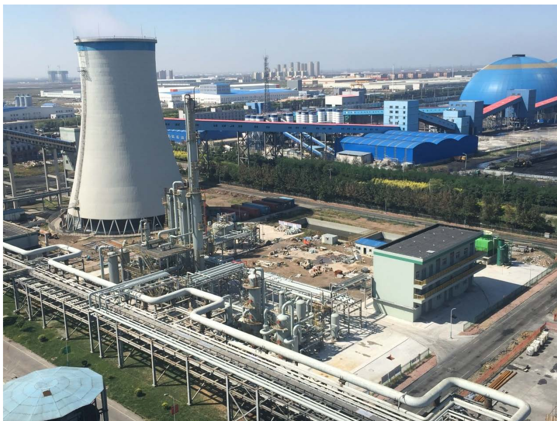
图 2 华能天津 IGCC 电站燃烧前捕集装置 Fig.2 Pre-combustion \text{CO}_2 capture unit in Tianjin IGCC Plant
