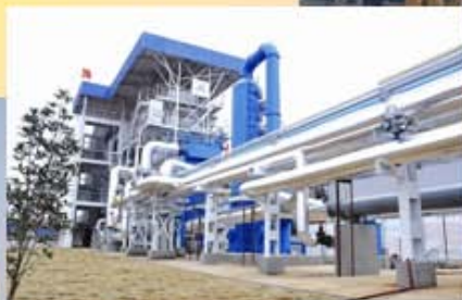
2011年 3MW t 全流程验证试验系统
