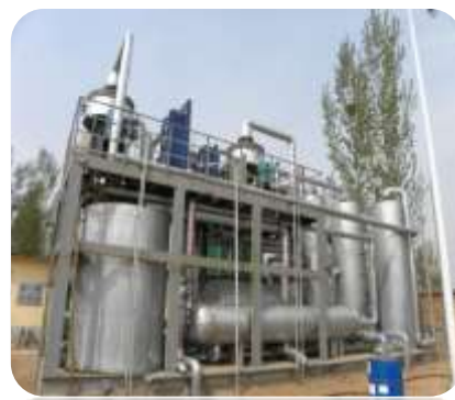
化学吸收脱碳系统
