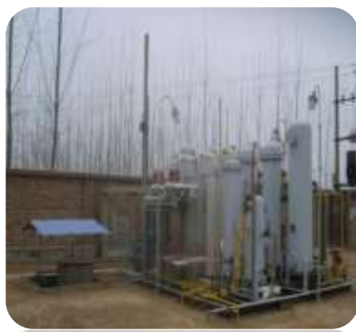
变压吸附脱碳系统
