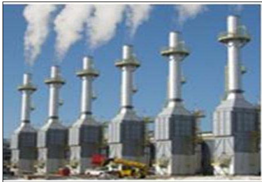
注汽站10台23t/h注汽锅炉
